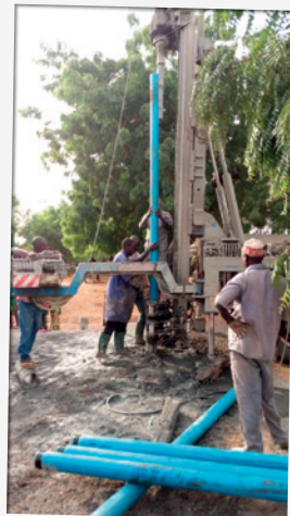
FORAGE. GOUTTE À GOUTTE (CAMEROUN)
