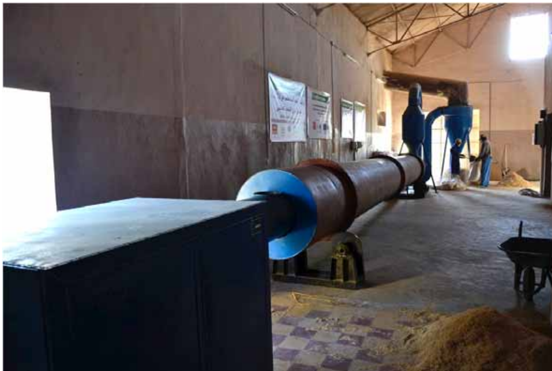
14. Vue d'ensemble du séchoir rotatif avec un premier plan, le foyer de combustion, au deuxième, le tambour et au troisième plan, le filtre cyclone et la sortie.
