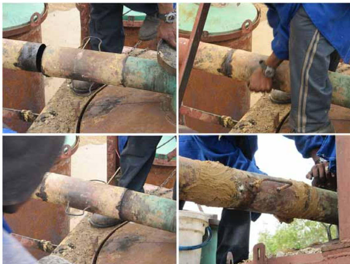
41. Mise en place du raccord entre le couvercle et le conduit et réalisation du joint d'argile
