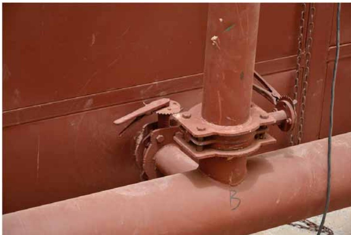
Figure 42 : Vannes permettant de gérer la circulation des gaz de pyrolyse récupérés
